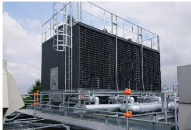
(屋上) 設置冷却塔によるフリークーリング
