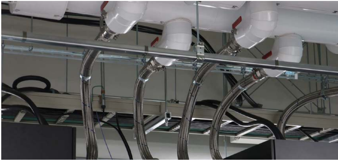
天井に配管、各CDUへ
