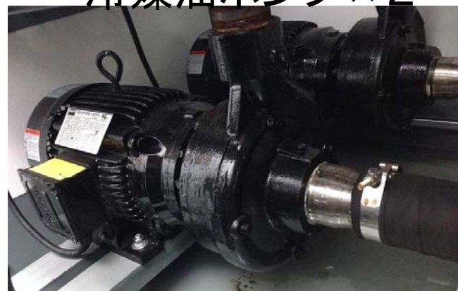
冷媒油ポンプ × 2
